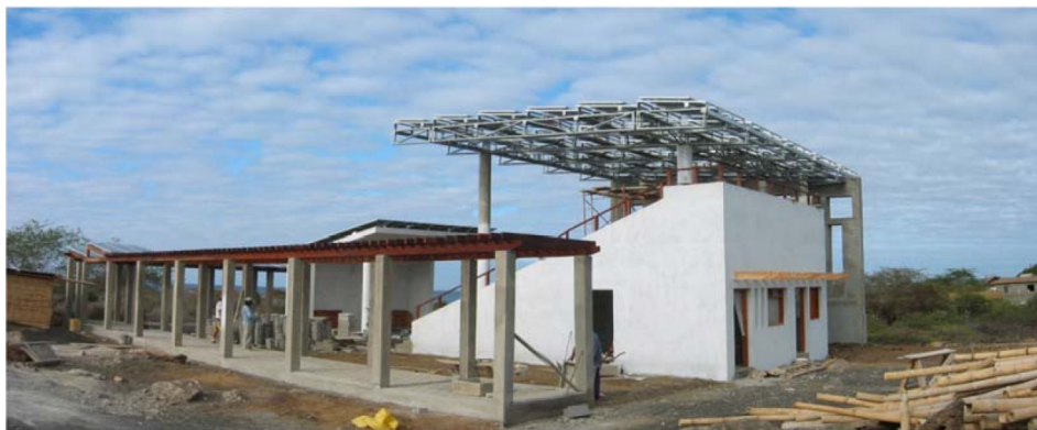
Figura 57: Generador Fotovoltaico de la micro-red de Floreana (islas Galápagos), Ecuador, 2003.
